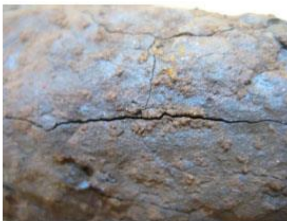
Ovan: detaljbild av sprickor i korrosionen.
