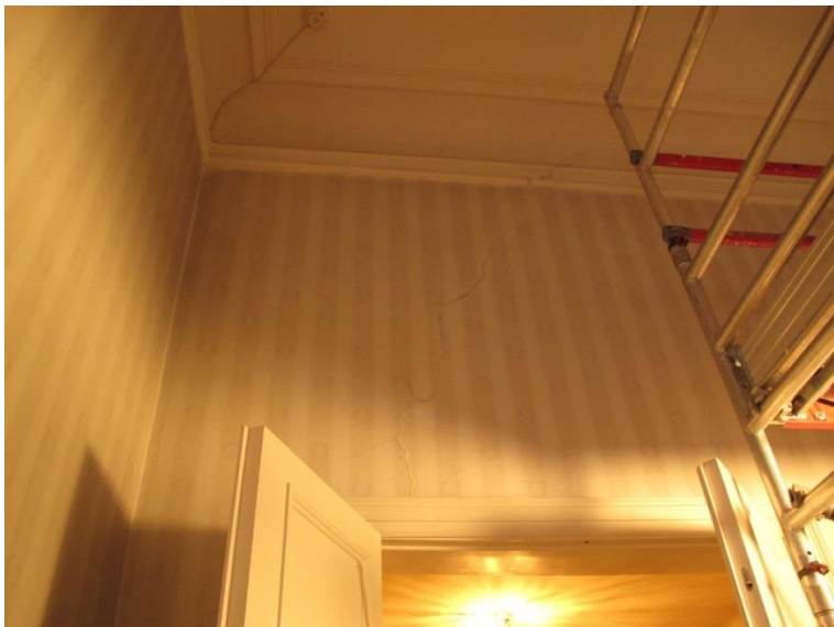
Bild 5: Stora sprickor fanns i väggen över dörr mot rum 3018.
