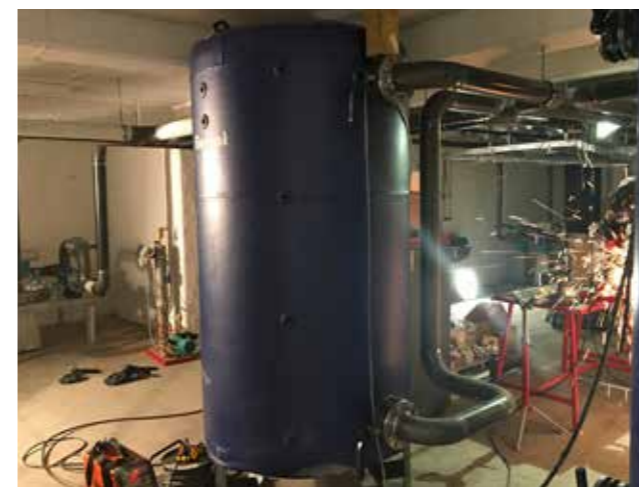
Det er ikke lite som skal til av tekniske installasjoner. Her fra pumperommet for jordvarmen.
