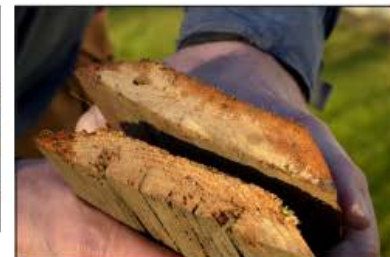
LÆRDOM: Takbordet til høyre er tettvokst og mer motstandsdyktig. Takbordet til venstre er mindre tettvokst og tåler derfor mindre.
