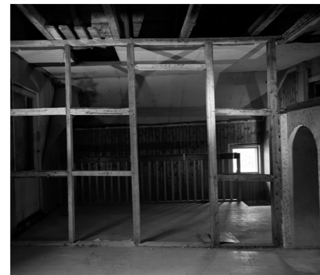
Kledningen er fjernet i et av soverommene i Olderfjord og alle delene i bindingsverket er nummerert. Huset var bygd særdeles samvittighetsfullt og presist, noe som også kan ses i den flott utførte ovnsnisjen. Bildet er utstilt i Porsanger rådhus.
