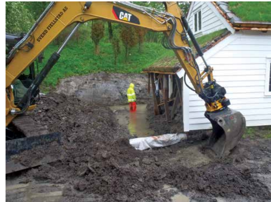
Mye vann i drengroft under vestre borgmur. Grøften ble isolert, fylt med drenerende masser og drenerør som leder vannet ut av tunet. Avbildet: ukjent. Foto: Norsk Folkemuseum.
