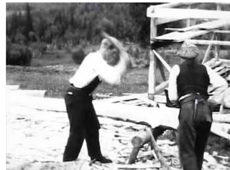
Utsnitt fra Hilmar Stigums film «Flat-teljing av tømmer i Vefsn 1933» viser godt og ledig samarbeid med fin driv i arbeidet. Her har vi et sjeldent eksempel på dokumentasjon av arbeidsprosesser knyttet til tømring. På ullsiden er det bedre stilt. Anna Grostøls samlinger hører til på Norsk Folkemuseum. Samlingen inneholder en mengde stoffer og materialprøver fra tekstilproduksjon og hun var aktiv med filmkamera.
