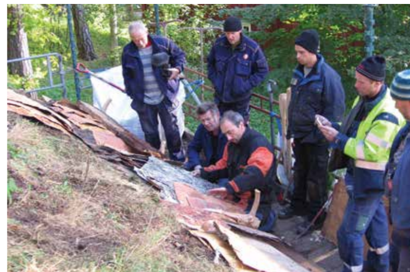
Vøling av nevertak på Sagastua. Sittende foran fra venstre: Steinar Mølster og Trond Oalann.
