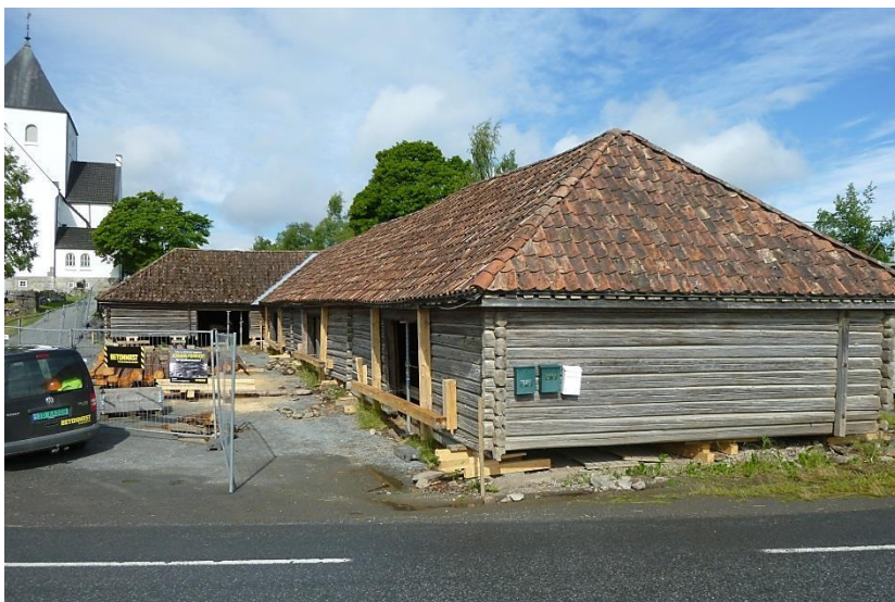
De fredete kirkestallene ved Ås kirke i Vestre Toten settes i stand med støtte fra Norsk Kulturminnefond, Stiftelsen UNI og Riksantikvaren. Foto: Betonmast Toten, avd. Bygningsvern.
