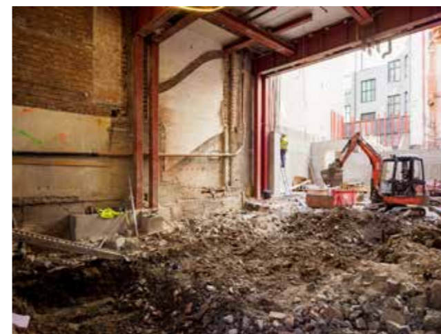
Deler av kjeller og 1. etasje i Arbins gate 1 er revet bort for å gi plass til teaterscenen. All masse blir løftet over gården, og alt byggemateriale blir løftet samme vei inn. Den første gangen håndverkerne var i bakgården og fikk vite hva de skulle være med på, tenkte de fleste at dette er et helt umulig oppdrag. Foto: Ole Walter Jacobsen
